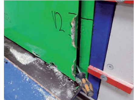
Schadensbild nach Angriff an der Nebenverriegelung
